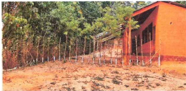
Foto 5: se observa El cerco en mal estado
