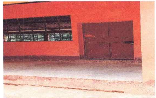
Foto 4: puertas perforado por oxido de las aulas.
